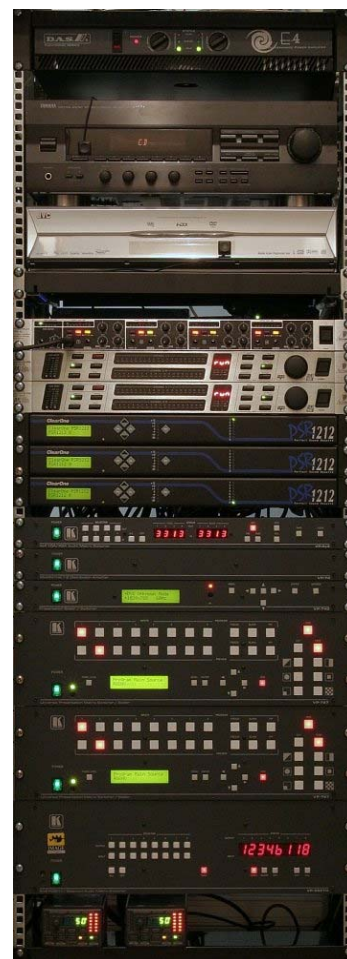
Osazení racku 19" v režii
