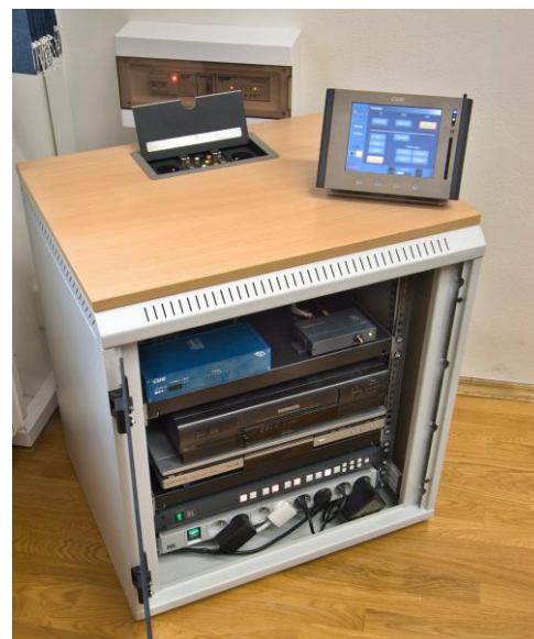
Kompletní vybavení navazujícího sálu je instalováno v mobilním racku
