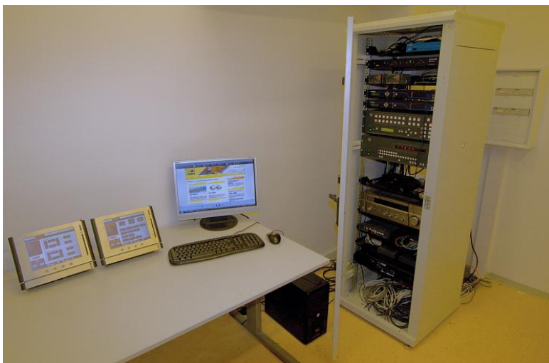
Technická místnost, AV technika v racku 19", dotykové LCD obrazovky
