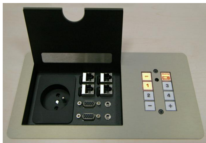
Konektorové pole s řídicí jednotkou, vstupy VGA + audio, zapnutí projektoru spouští elektrické plátno
